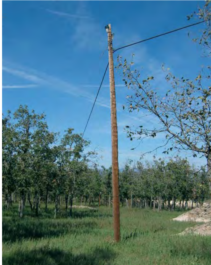
Figura 8.10. Poste de madera de los tendidos eléctrico y telefónico
